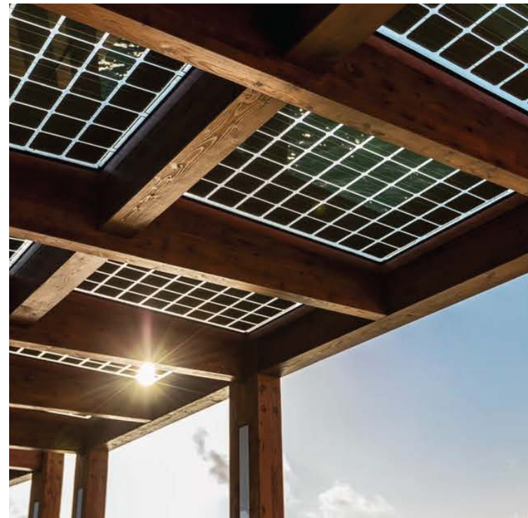
Painel de energia solar
